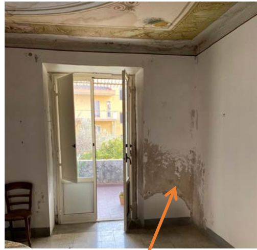
Fenomeni di degrado della muratura
